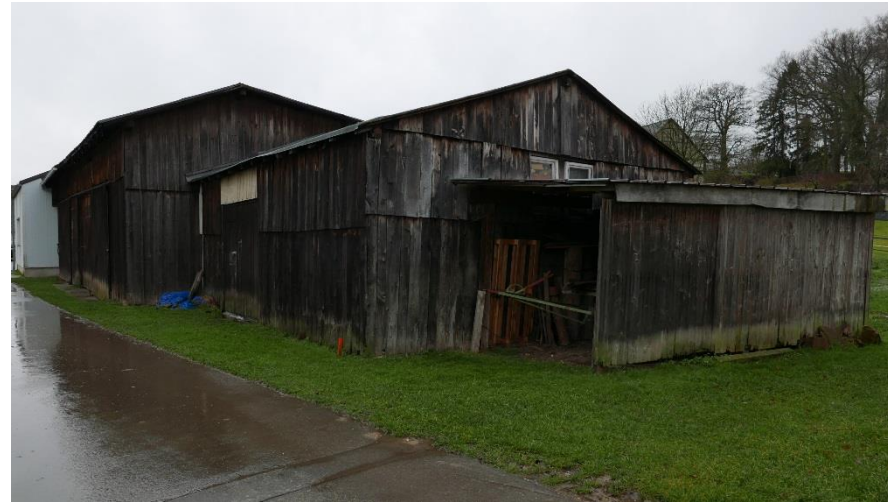
Blick auf den baufälligen Schuppen am Bauhof
